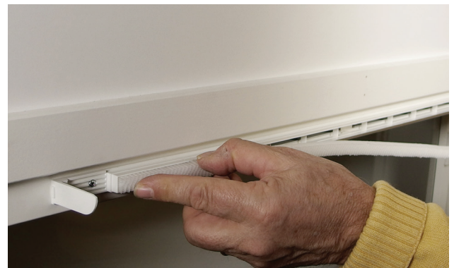
Elektrostaattisen allergeenisuodattimen vaihto
